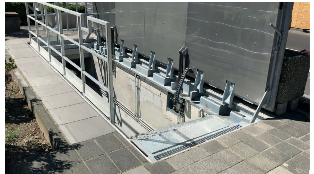
Uscita scala con pannelli di protezione antincendio e lamiera di protezione.
